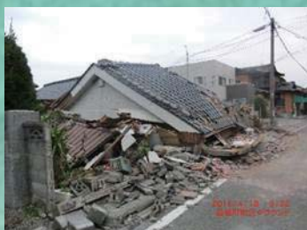
益城町の木造被害
