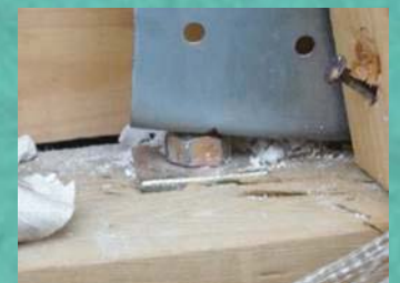
金物設置不備
