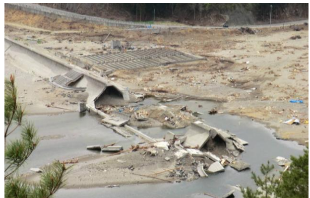
図-1 東北地方太平洋沖地震による防潮堤の被害（東京大学 古関教授撮影）
