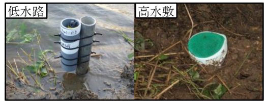
図-2 水位計設置状況
